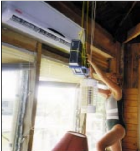
Kühlung ist alles! Hier hat die XYL das Schaltenteil direkt vor die Klimaanlage gehängt.
